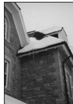
La maçonnerie extérieure doit être rejointoyée.
