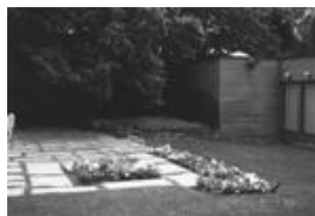
Les pierres de patio qui ne sont pas de niveau constituent un danger physique.
