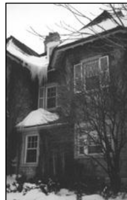
Le manque d'isolation cause des pertes d'énergie.
