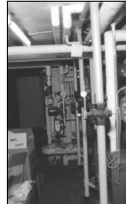
Chauffe-eau au gaz.
