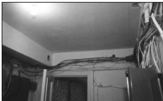
Le filage électrique a été refait dans les années 1950; on devrait le refaire à nouveau.
