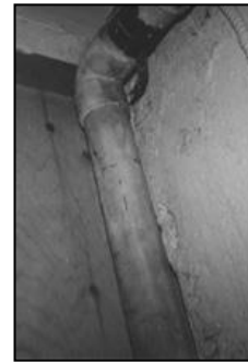
Les tuyaux en acier galvanisé pour les eaux usées ont excédé leur vie utile.
