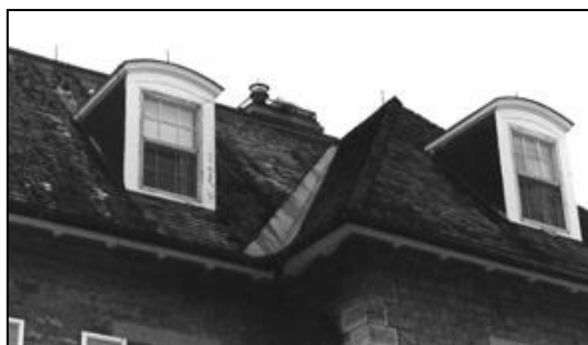
Les bardeaux ont excédé de beaucoup la fin de leur vie utile et sont vulnérables aux infiltrations d'eau.
