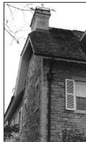
Les gouttières et les drains verticaux ont besoin d'être remplacés.
