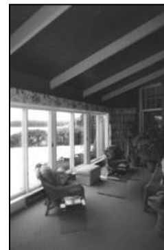
Le solarium n'est pas isolé et l'on considère qu'il ne rencontre pas les standards.
