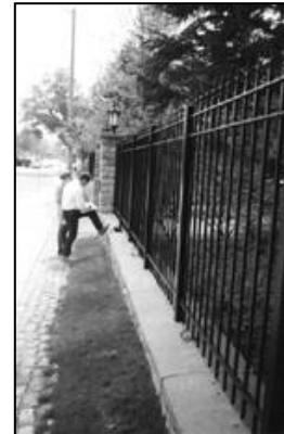
La clôture et les grilles à l'avant du terrain sont à la fin de leur vie utile et doivent être remplacées.
