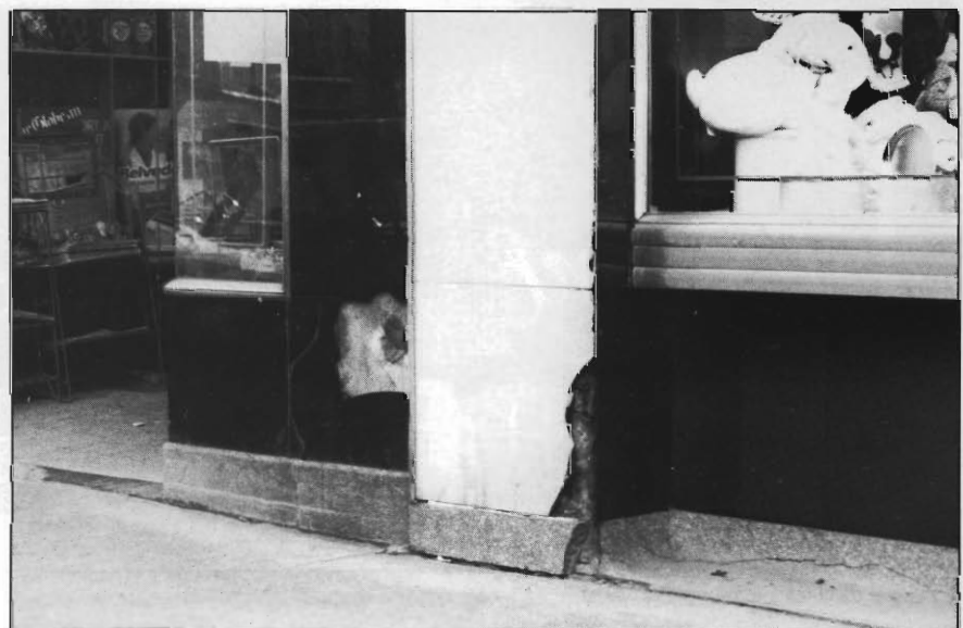
Au niveau du sol, l'entretien du trottoir et le manque d'entretien des panneaux de verre causent des problèmes qui peuvent s'avérer importants.
